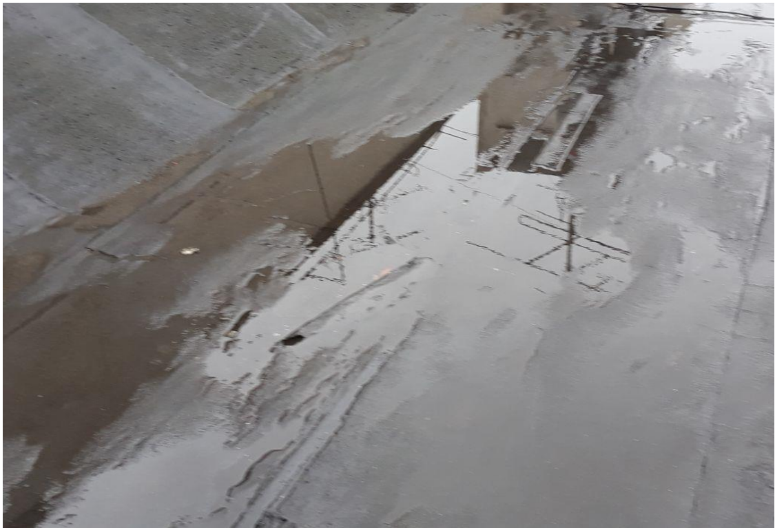
Фотография 13. Места застаивания воды на кровле шестиэтажного корпуса
