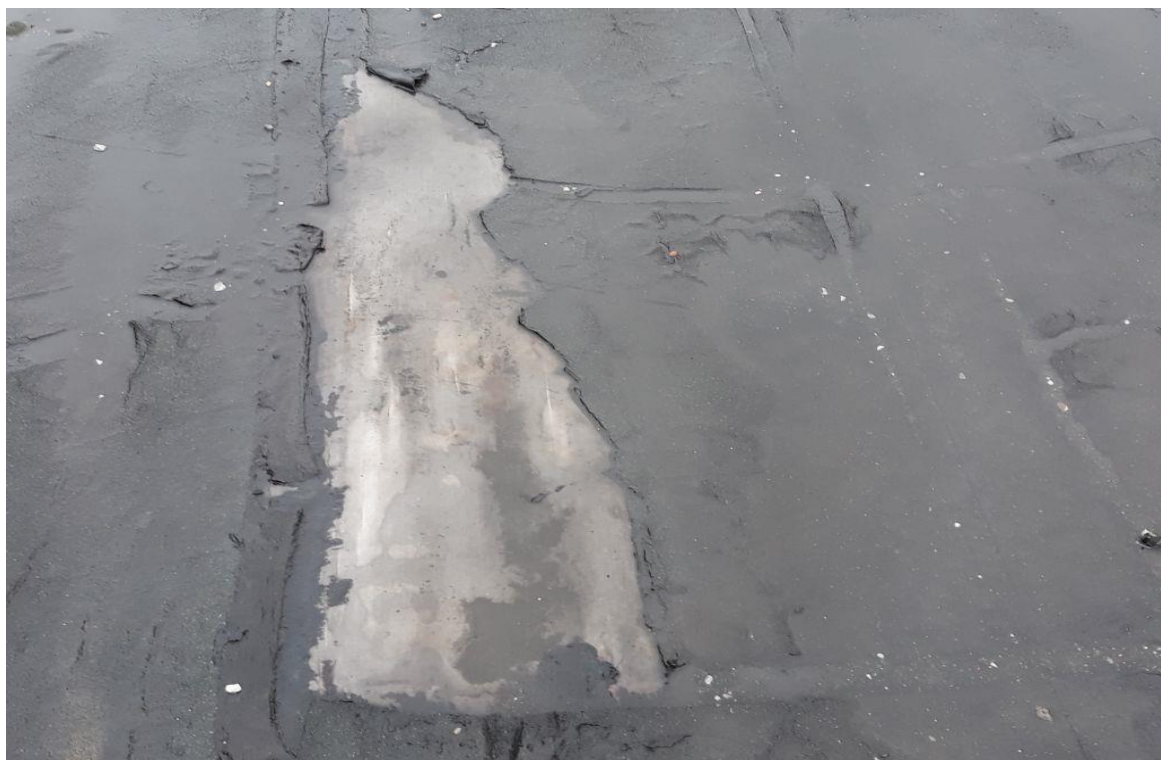
Фотография 15. Разрушение водоизоляционного ковра на кровле шестиэтажного корпуса
