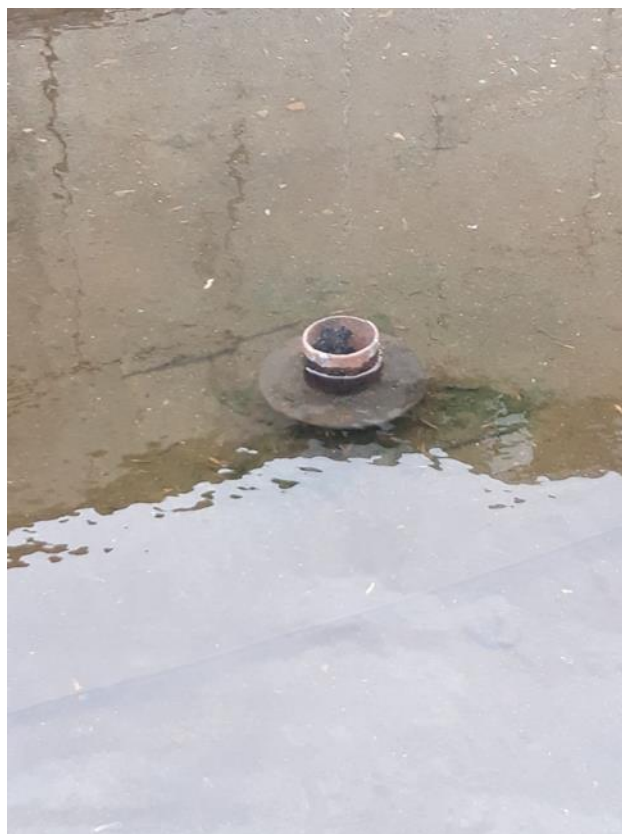
Фотография 19. Места застаивания воды на кровле двухэтажного корпуса
