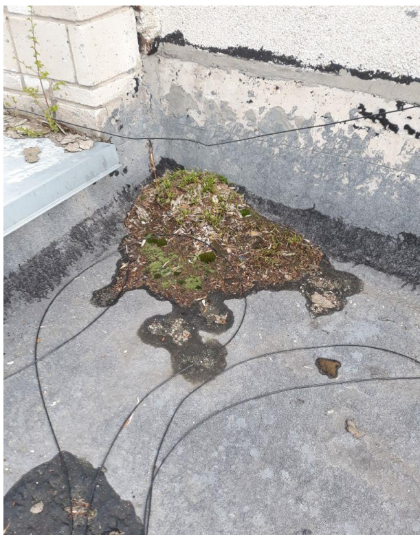
Фотография 25. Прорастание растительности на кровле двухэтажного корпуса
