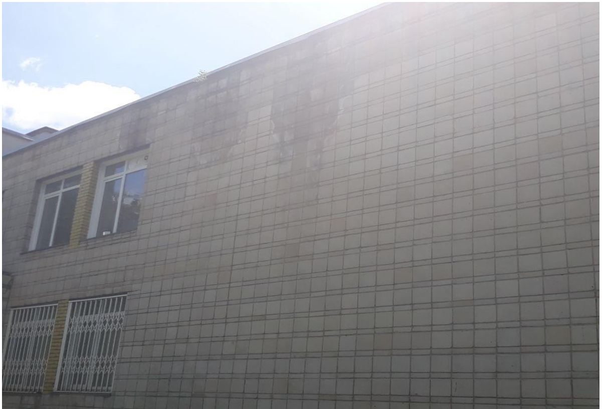
Фотография 4. Фасад в осях 20/А-Ж. Места замачивания фасада
