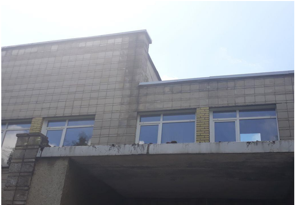
Фотография 3. Фасад в осях 20/А-Ж. Места замачивания фасада
