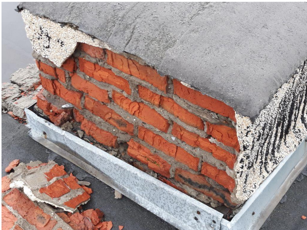
Фотография 8. Разрушение кирпичной кладки вентиляционных шахт на кровле шестиэтажного корпуса
