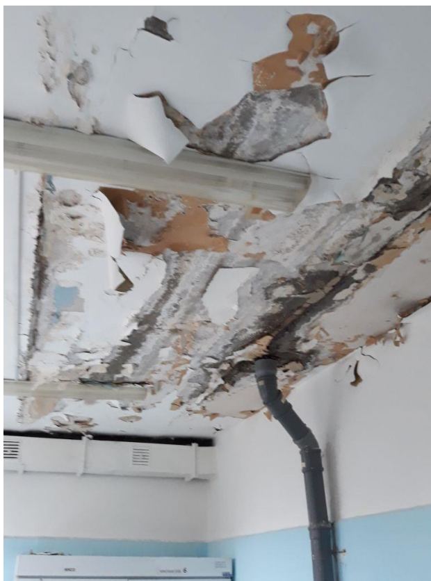
Фотография 29. Участки замачивания покрытия в осях 19-20/А'-Б'
