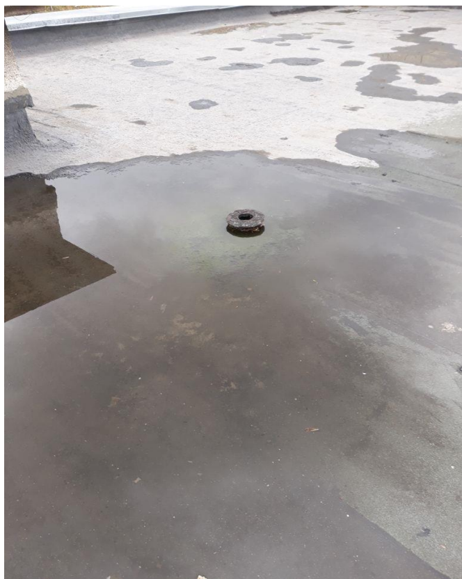
Фотография 17. Места застаивания воды на кровле двухэтажного корпуса
