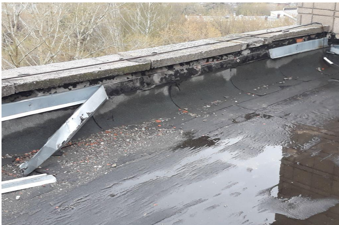
Фотография 10. Состояние прижимных планок на кровле шестиэтажного корпуса
