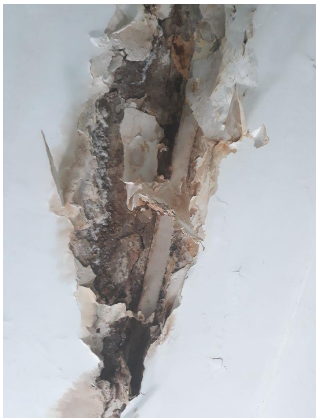
Фотография 31. Отслоение бетона плит покрытий в осях 19-20/А'-Б'
