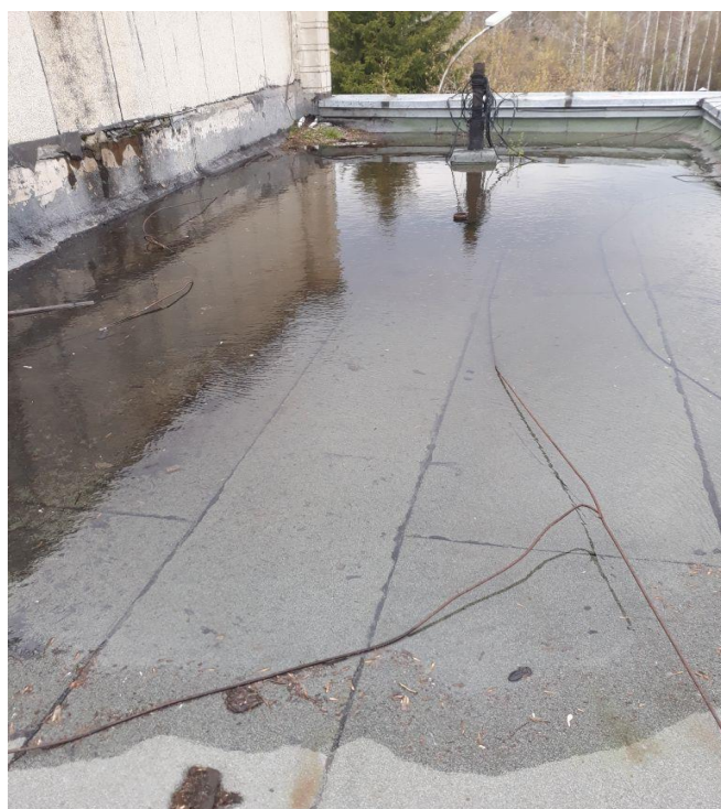
Фотография 22. Участок застаивания воды в осях 19-20/А'-Б' в месте протечек на кровле двухэтажного корпуса
