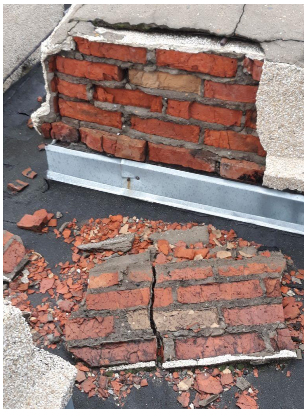
Фотография 9. Разрушение кирпичной кладки вентиляционных шахт на кровле шестиэтажного корпуса
