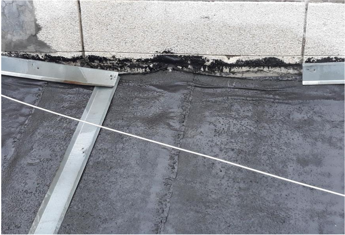
Фотография 11. Состояние прижимных планок на кровле шестиэтажного корпуса
