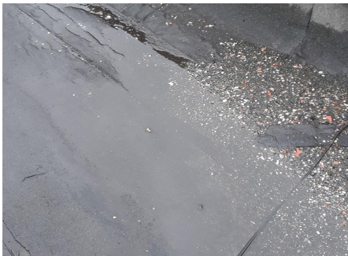
Фотография 16. Воздушные мешки в кровле шестиэтажного корпуса
