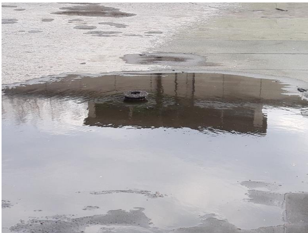
Фотография 18. Места застаивания воды на кровле двухэтажного корпуса
