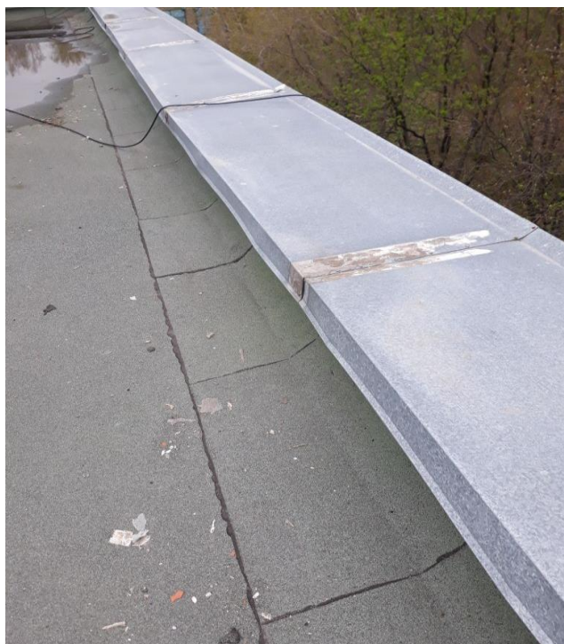
Фотография 21. Состояние фасонных элементов парапетов на кровле двухэтажного корпуса
