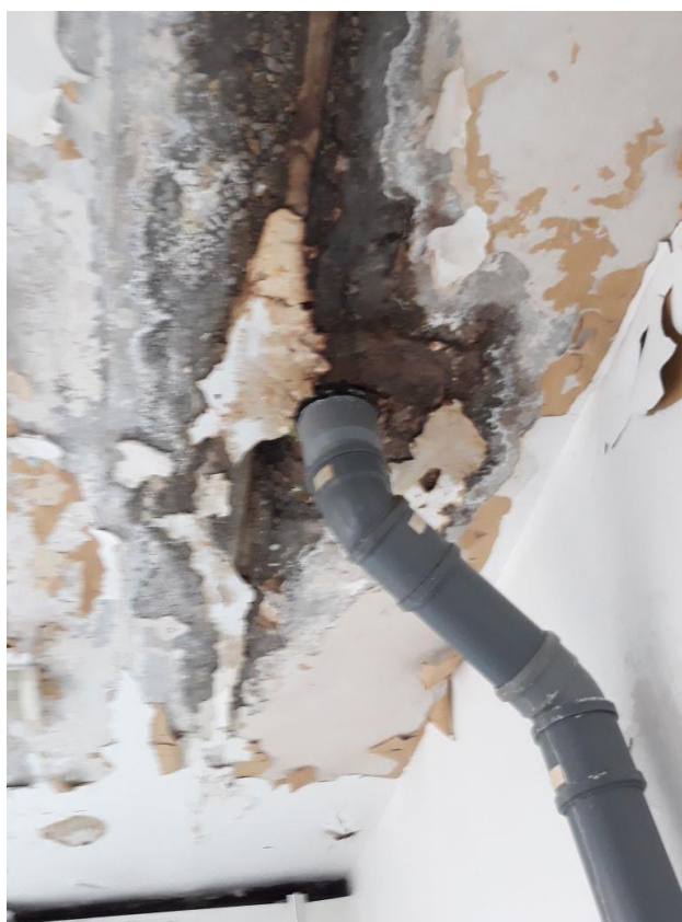
Фотография 30. Участки замачивания покрытия в осях 19-20/А'-Б'
