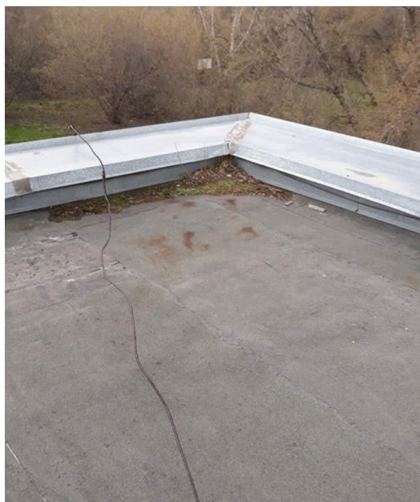
Фотография 26. Прорастание растительности на кровле двухэтажного корпуса
