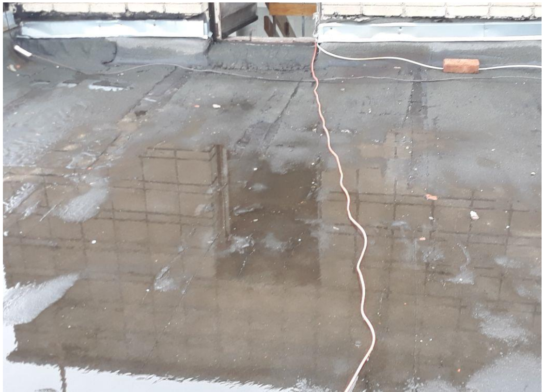
Фотография 12. Места застаивания воды на кровле шестиэтажного корпуса
