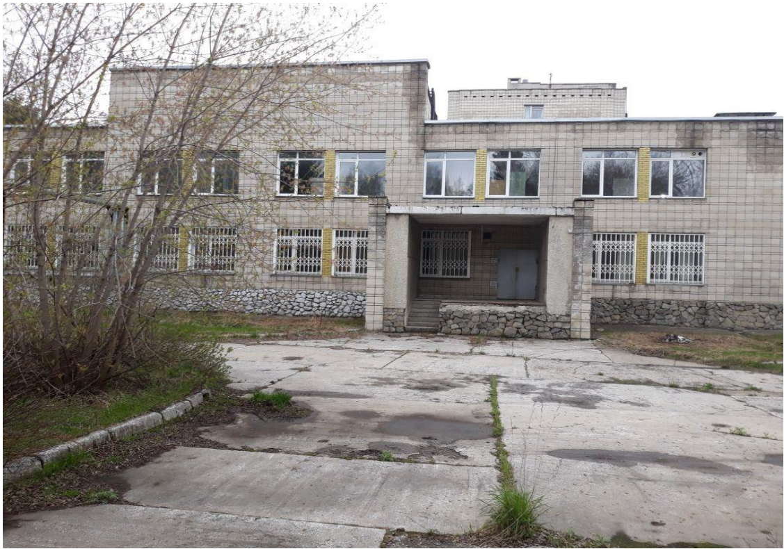
Фотография 5. Фасад в осях 20/А-Ж. Места замачивания фасада
